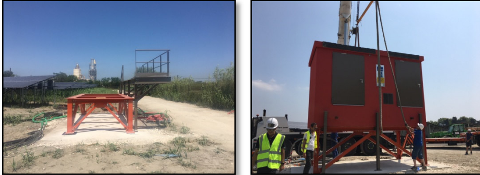
Poste de transformation (exemple)
