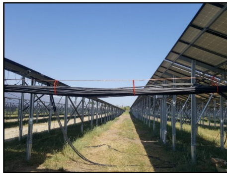
Réseau électrique entre les tables (exemple)
